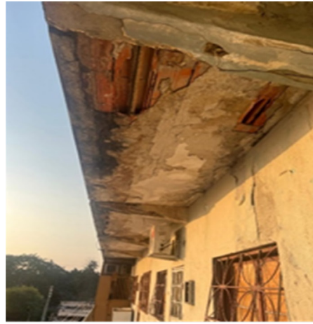
fissuras e deformação no pavimento e parede
