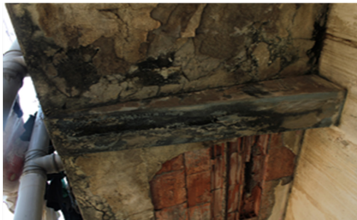
c) Infiltração nas lajes das varandas em consola
