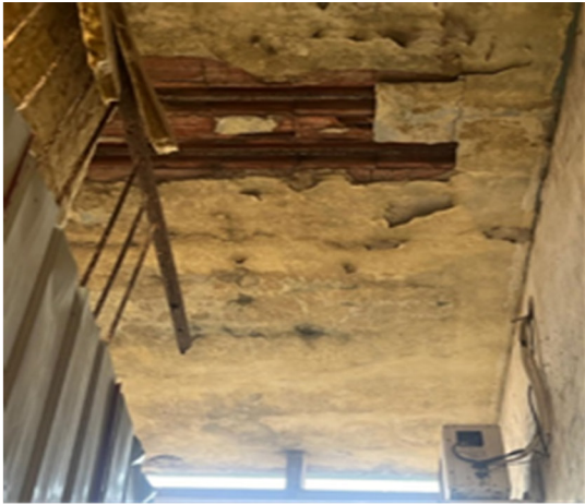
Fissuras e degradação da caixa de escada
