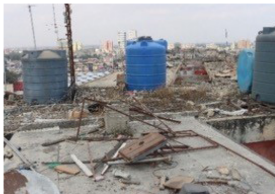
Excesso de cargas na laje.
