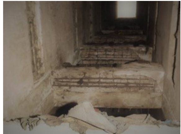
Anomalia ao longo das vigas.
