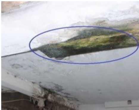
Parasita na estrutura.
