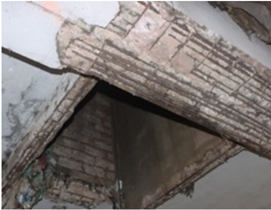
Corrosão do betão e da armadura.
